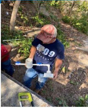
Instalación de clorinadores en el tanque barrio el tanque sistema el Zarzal.
