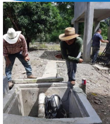
Control y mantenimiento de las bombas sumergibles para una calidad de funcionamiento.
