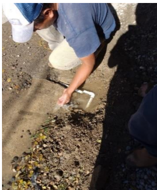
Arreglo de cajas de agua en el área urbana.
