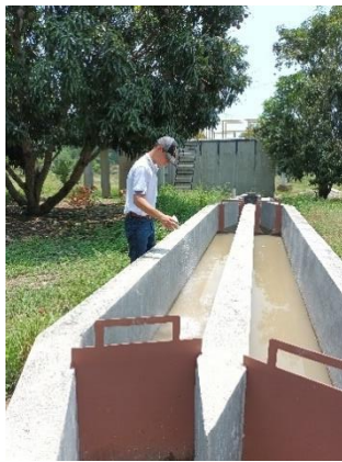
Limpieza de los tubos de descarga a los filtros que van hacia los humedales.
